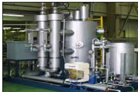
化学プラント用蒸気ボイラー
